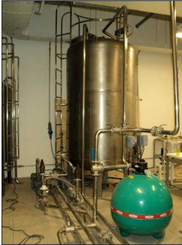
Figura 4-3. Tanque de armazenamento de água.
